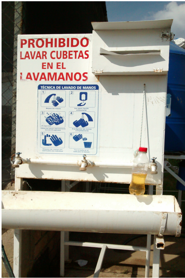
Lavamanos para personal de campo, ubicado afuera de la galera.
