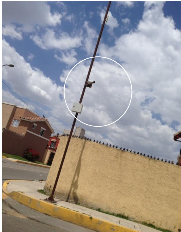
Fotografía 7. Cámara instalada en la avenida principal de Real de Verona
